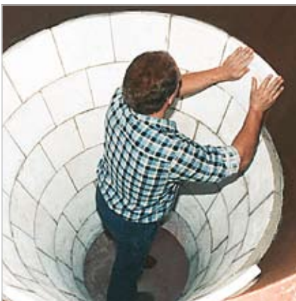
Auskleidung eines Staubabscheiders mit KALCOR
