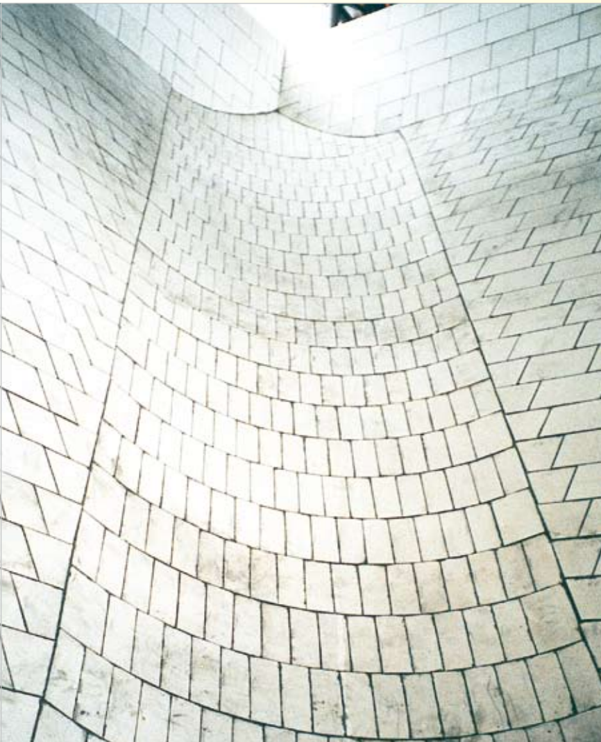
Skip-Sammelschurre mit KALOCER Auskleidung in einem Hochofenwerk in Europa; die Formstücke haben eine Dicke von bis zu 50 mm und sind zum Teil 3-dimensional geschnitten
