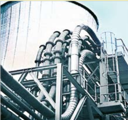
Flugascheleitungen in einem Kohlekraftwerk
