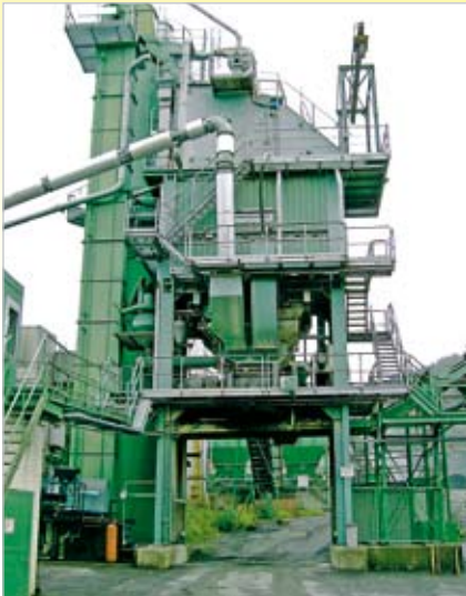
Asphaltmischer unterliegen erheblichem Verschleiß; sie werden sicher mit KALMETALL-C geschützt
