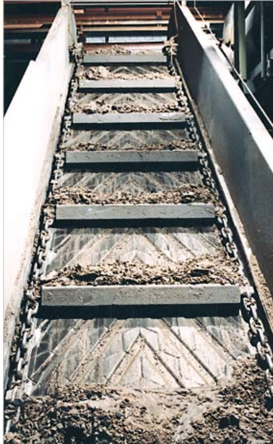
Kettenförderer für die Nassentaschung in einem Kraftwerk. Eingegossene Abflussrinnen in der Auskleidung verhindern das unerwünschte Mitführen von Wasser in den Ausstragsbereich und senken den Wasserverbrauch.
