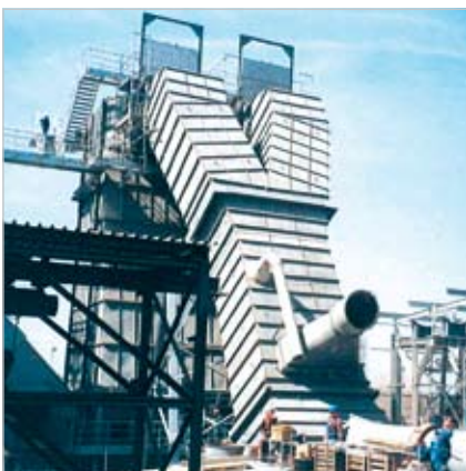
Sicherer Schutz der Entstaubungsleitung eines Klinkerkühlers mit KALCRET-BNY unter Einsatz vorgefertigter Formstücke mit integrierter Isolation
