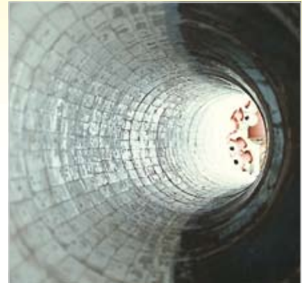
Rohrbogen mit kombiniertem Schutz aus ABRESIST und KALOCER
