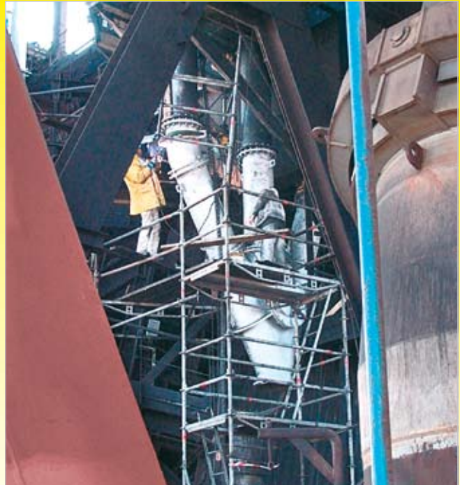
Druckausgleichs-Leitung im Hochofenbetrieb; der Grundwerkstoff hat eine Dicke von 30 mm, KALMETALL-W 100 von 6 mm; der Durchmesser beträgt 450 mm
