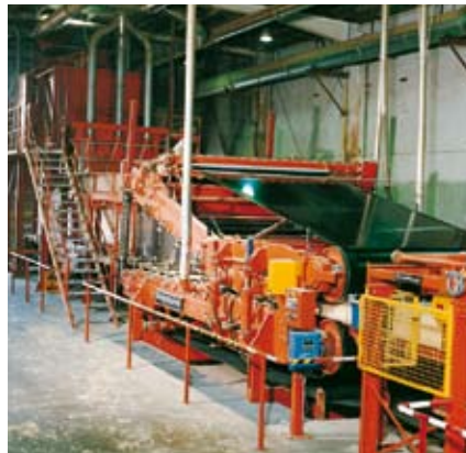
Vorpresenband bei der Spanplattenherstellung. Der Spankuchen wird während der Förderung zur Presse vorverdichtet.
