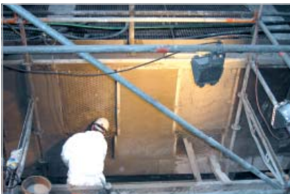
Auskleidung der Prallwand einer Koksrampe
