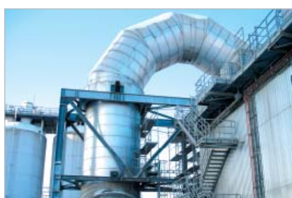
Klinkerstaub-Transportleitung in einem deutschen Zementwerk
