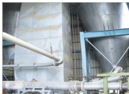
Ausgekleideter Zyklon im Zementwerk
