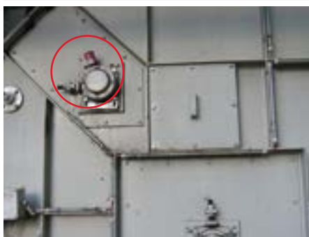
Flanschlagerschmierung eines Becherwerks
