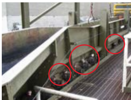
Lagerschmierung an der Baumsortierung
