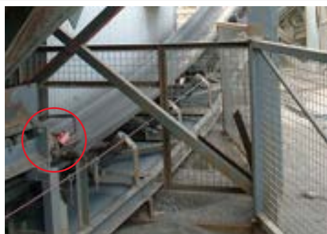
Stehlagerschmierung einer Bandwaage
