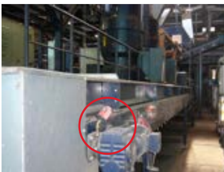
Flanschlagerschmierung einer Förderbandanlage
