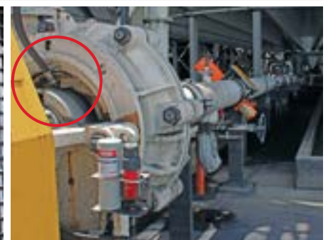
Lagerschmierung einer Pumpe
