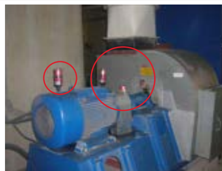
Elektromotoren- und Wellenschmierung eines Sekundärlüfters
