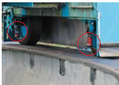
Radlagerschmierung an der Rundräumerbrücke
