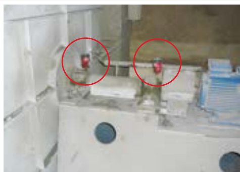
Stehlagerschmierng der Lüfterwelle
