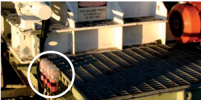
Schmierung verschiedener Lagerstellen an einem Kohlebrecher. Mit Hilfe des perma STAR konnten die Schmierstellen aus dem sicherheitsgefährdenden Bereich gelegt werden.
