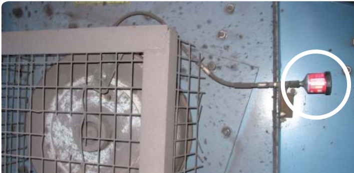
Permanente Schmierung eines Schwingsiebs in einem Kohlekraftwerk. Zuvor wurde manuell mit der Fettpresse geschmiert und das Schutzgitter von den Mitarbeitern ausgeschnitten um an die Schmierstelle zu gelangen.
