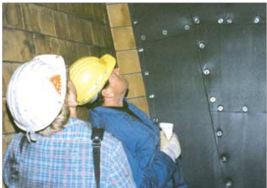
Auskleidungskombination in einem Feinkohle-Großbunker. Die unterschiedlich beanspruchten Flächen sind den Beanspruchungen entsprechend geschützt, hier z.B. mit KALCERAM und KALEN.
